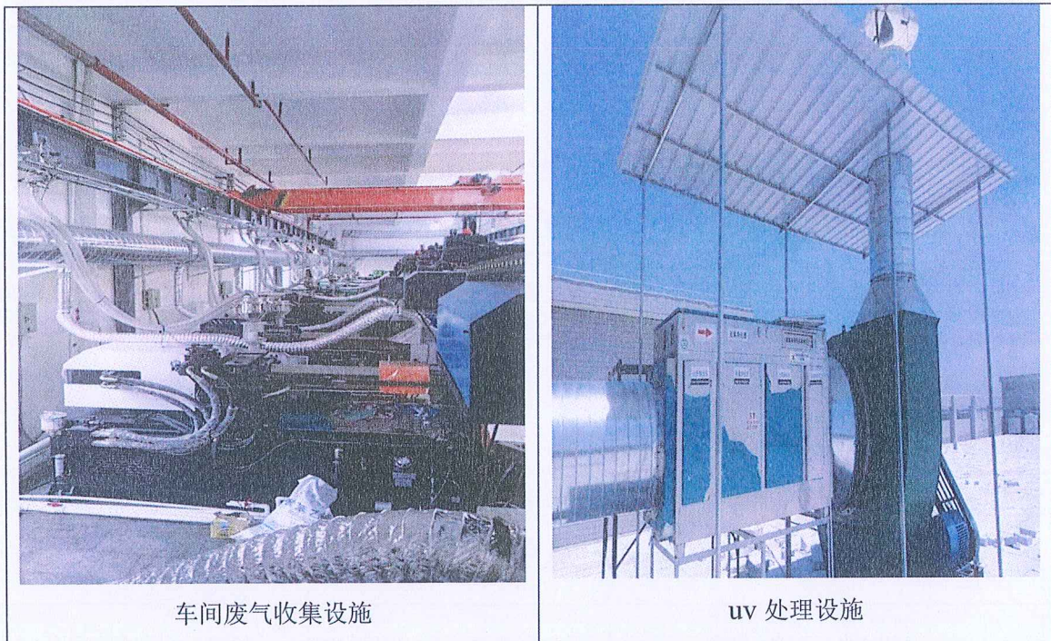
图 3.2-1 已建废气收集与处理设施
