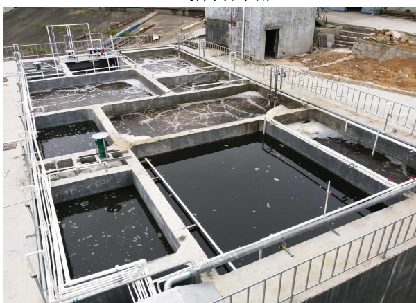
污水处理系统
