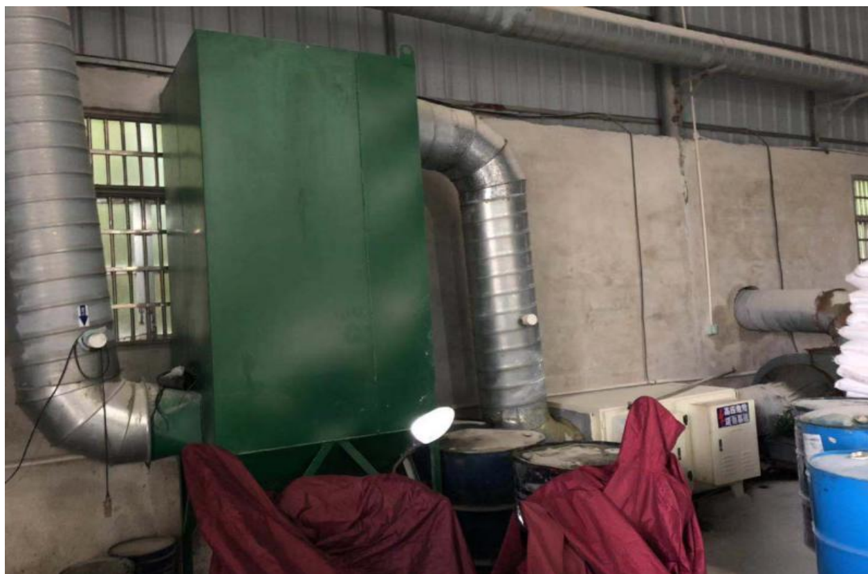
附件 2：主要处理设施相片
