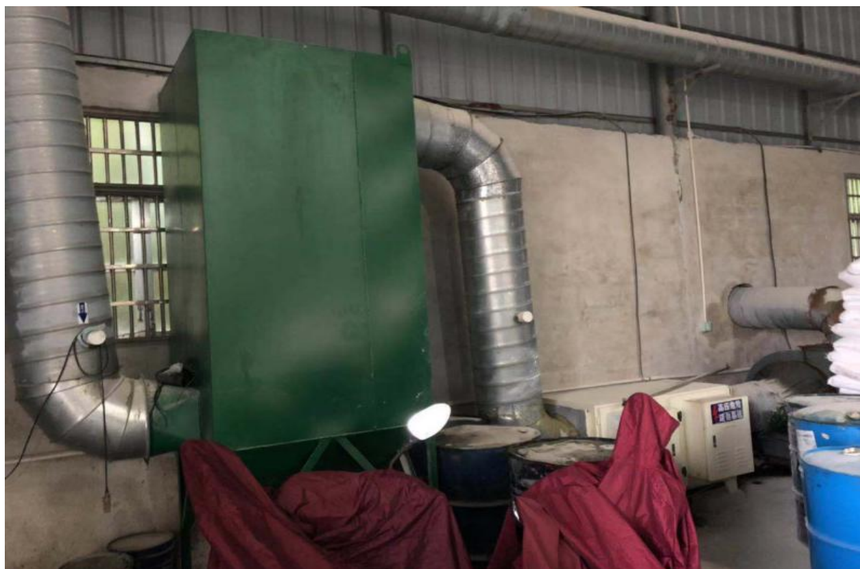
附件 2：主要处理设施相片
