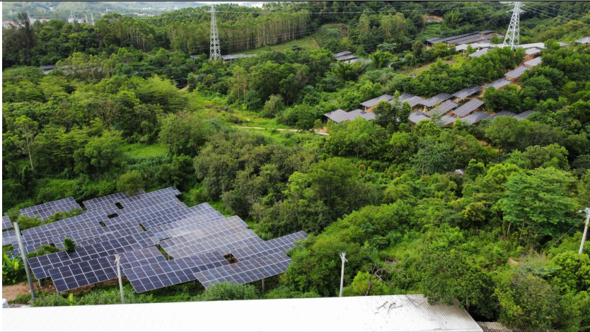
项目东北侧（山林及周边光伏组件）
