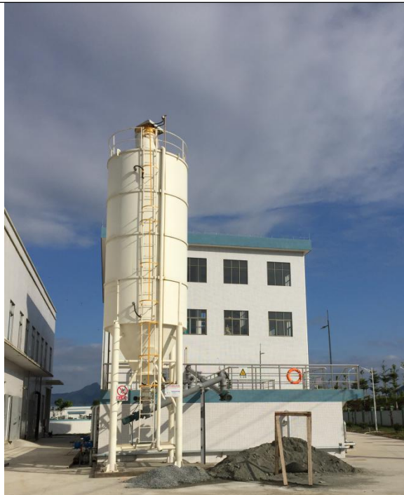
脱水系统、脱水房
