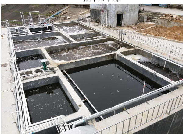
污水处理系统
