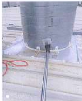
图三 喷漆废气排放口(处理后)
