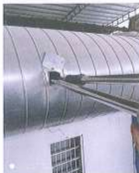
图二 喷漆废气采样口(处理前)
