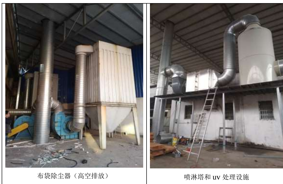
图 3.2-1 已建废气收集与处理设施
