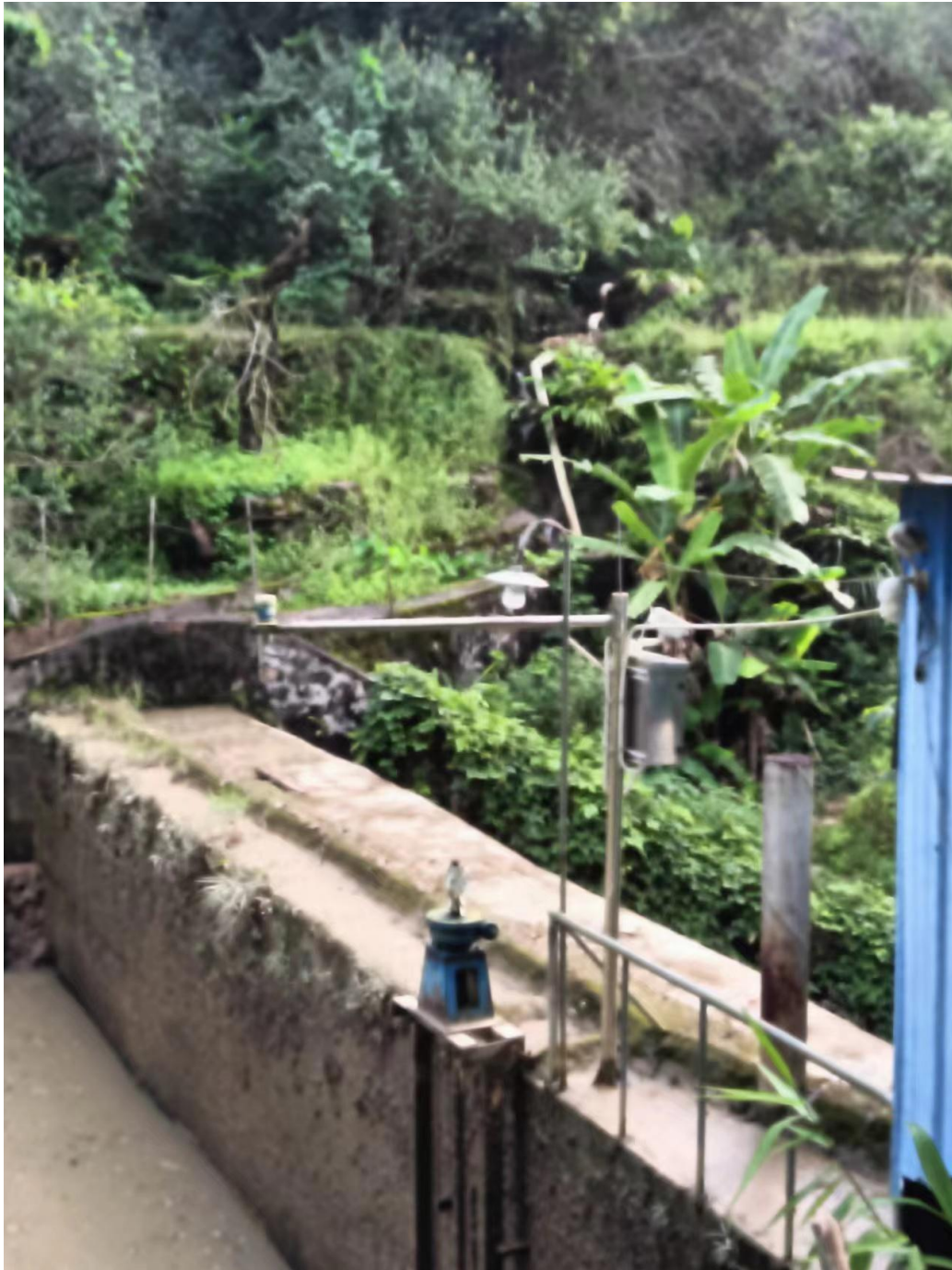
泄流闸+生态流量监控设施
