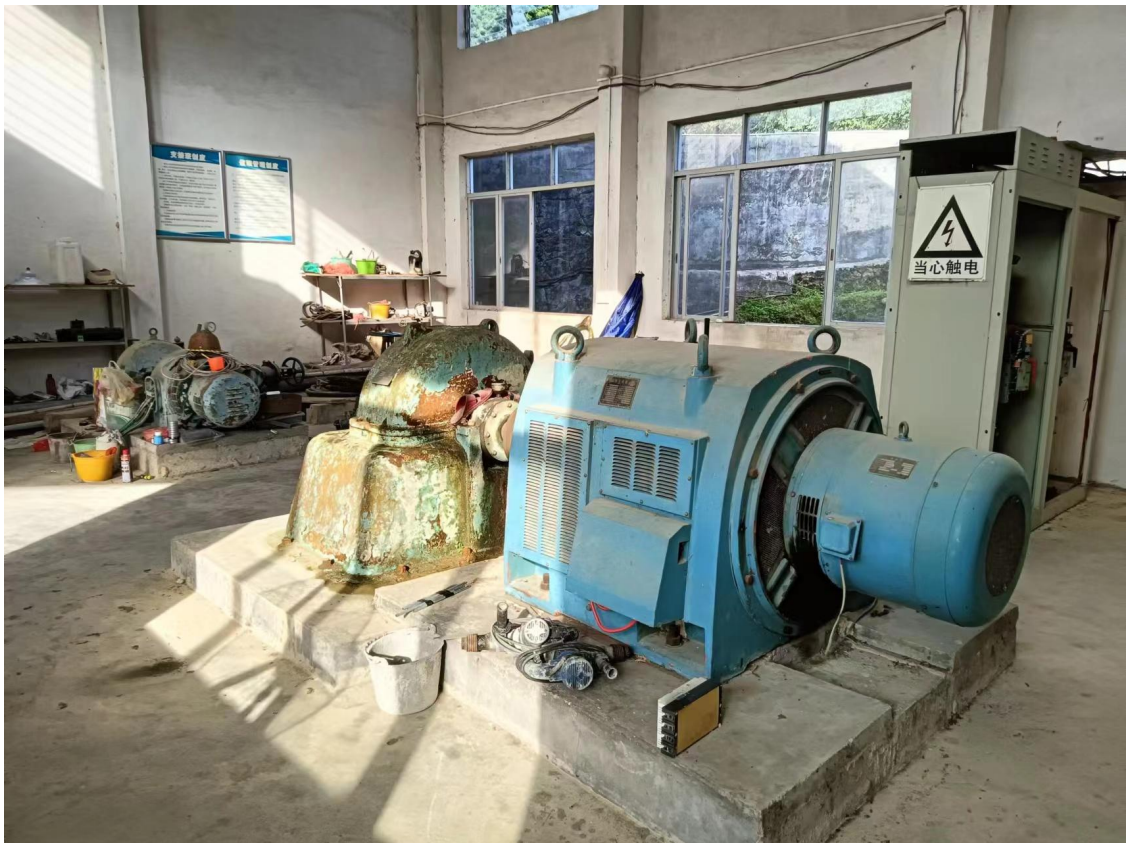
厂房内部发电机全貌
