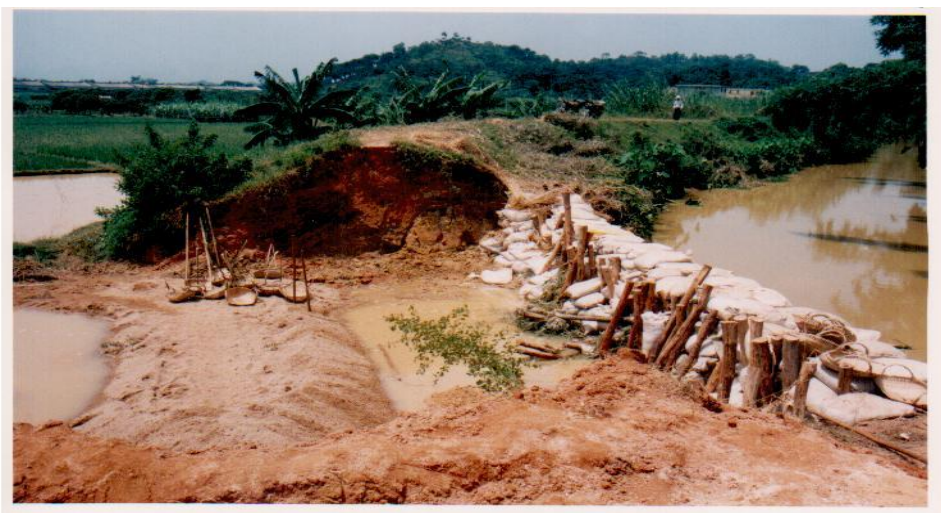
图 1-5 1993 年洪水冲毁堤防照片
